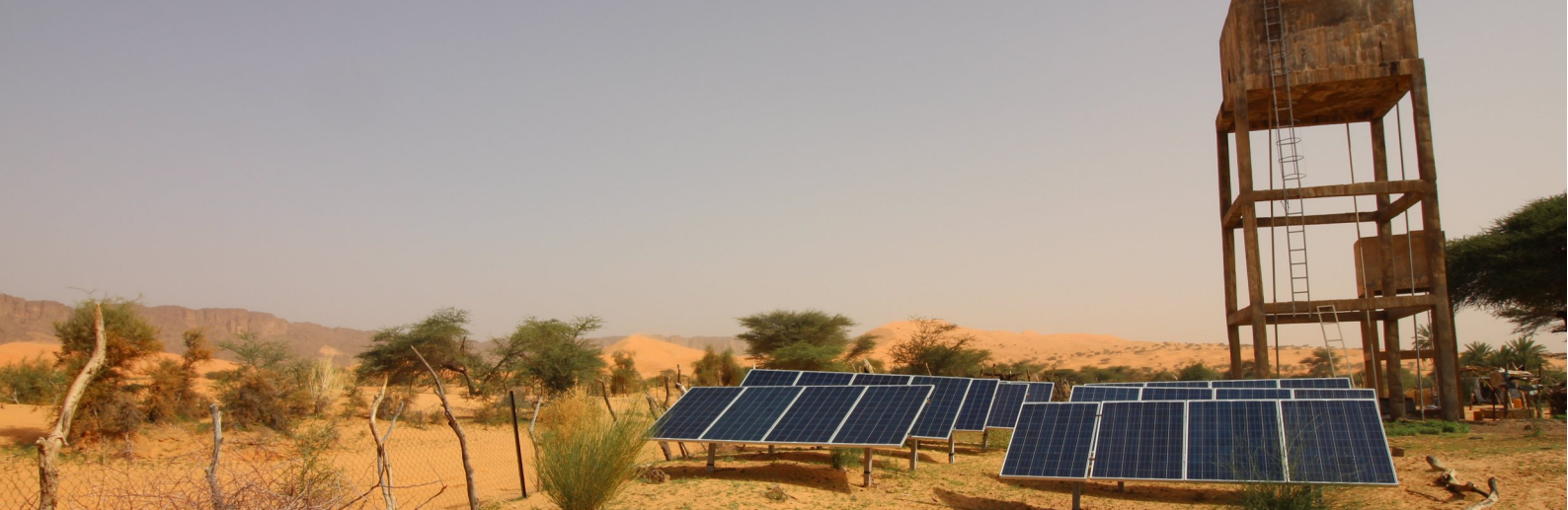
Bassin et panneaux solaires d'alimentation du pompage collectif
