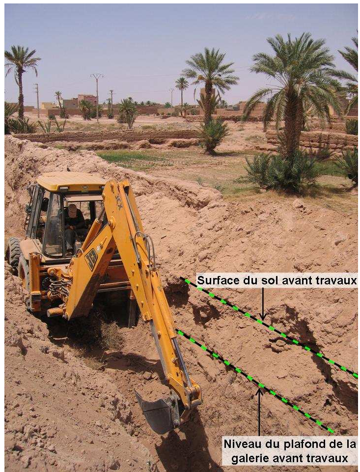
Figure 39 : déblaiement de la galerie avec un tractopelle, Boshabia (El Haen), 18-08-07 (source : personnelle)
